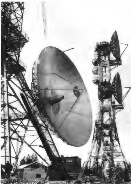
Montage des 10-t-Cassegrain-Richtfunkspiegels auf dem Torfhaus im Oberharz für eine neue 2-GHz-Richtfunkstrecke nach Berlin
